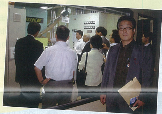
札幌ドーム コージェネレーションシステム
